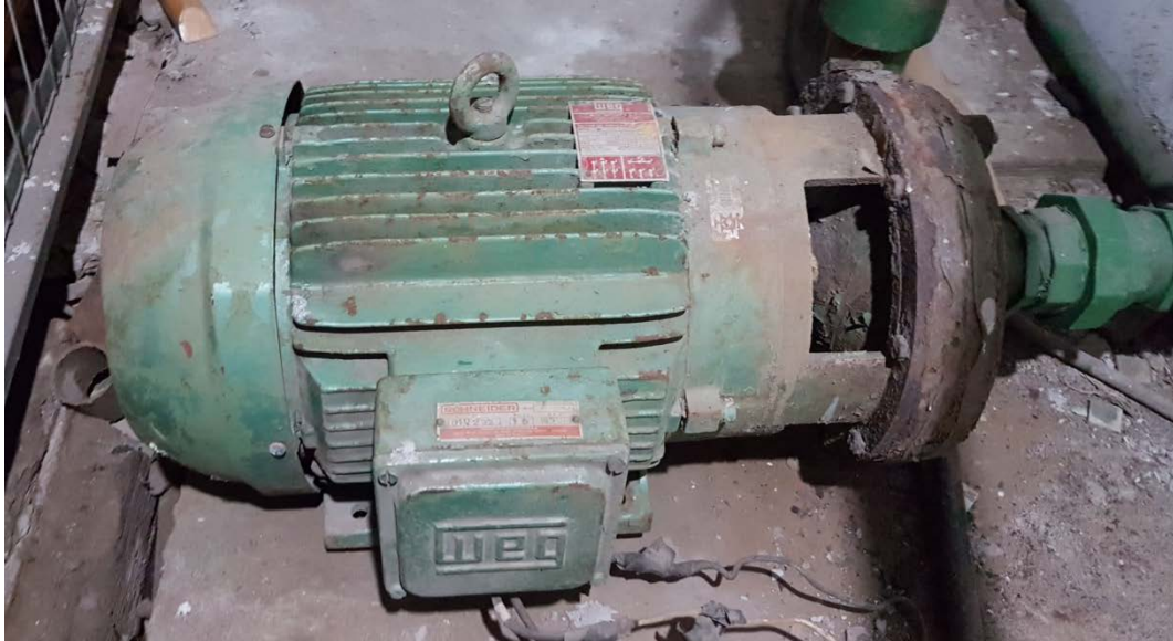
Figura 44 – Bomba de recalque da edificação
