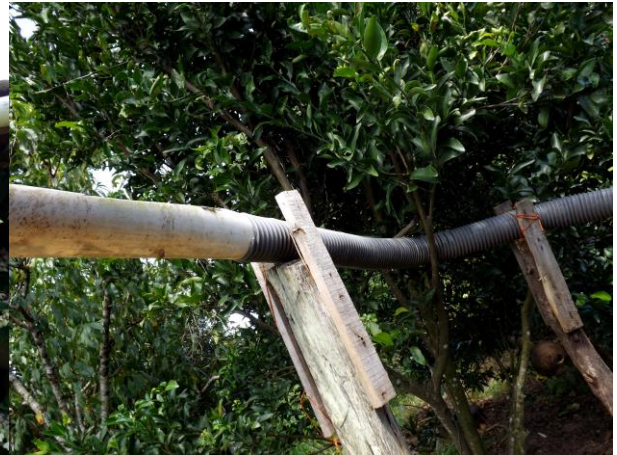
Figura 13 – Sistema de coleta de água da chuva. Fonte: Alecsandra Cunha – fev./2015.
