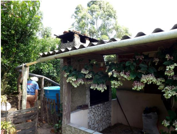
Figura 12 – Sistema de coleta de água da chuva. Fonte: Alecsandra Cunha – fev./2015.
