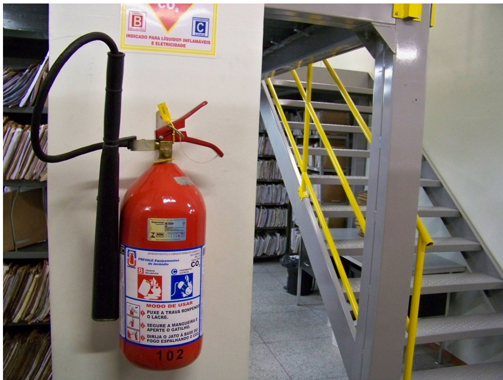
Figura 13: Extintor de CO 2 Fonte: Arquivo R. S.
