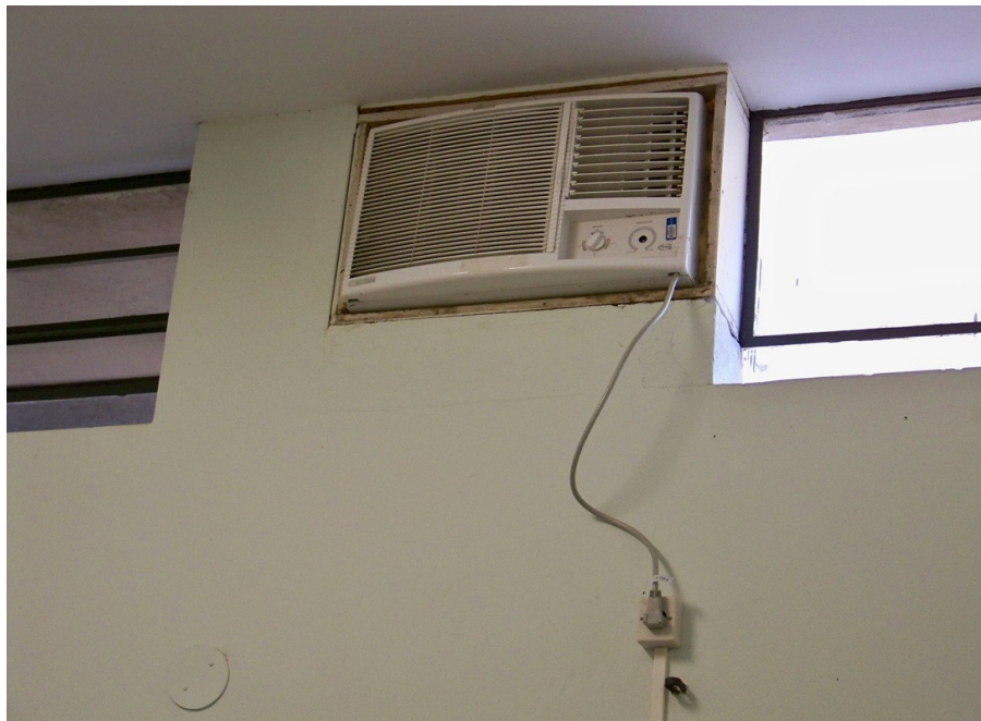
Figura 12: Ar condicionado do escritório administrativo do arquivo. Fonte: Arquivo R. S.
