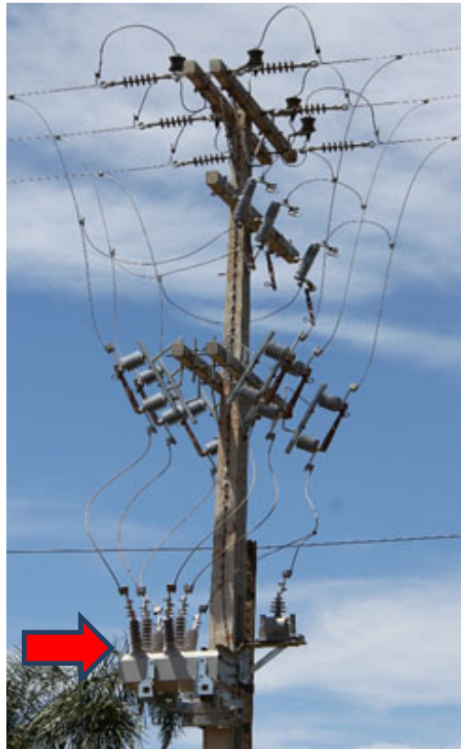
Figura 2.2 – Exemplo de equipamento religador em poste na RD da permissionária Coprel
