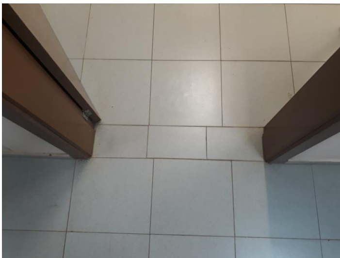
Figuras 3 – Piso da sala de aula, desencontrado por falta de planejamento
