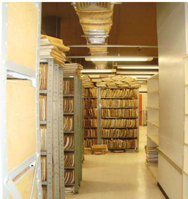
FIGURA 18 :Sistema de ventilação no teto, com altura para circulação do ar
