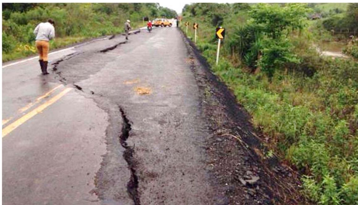
Figura 3.5 – Situação do trecho na RS-149 em outubro de 2015. Bloqueio do trânsito.
