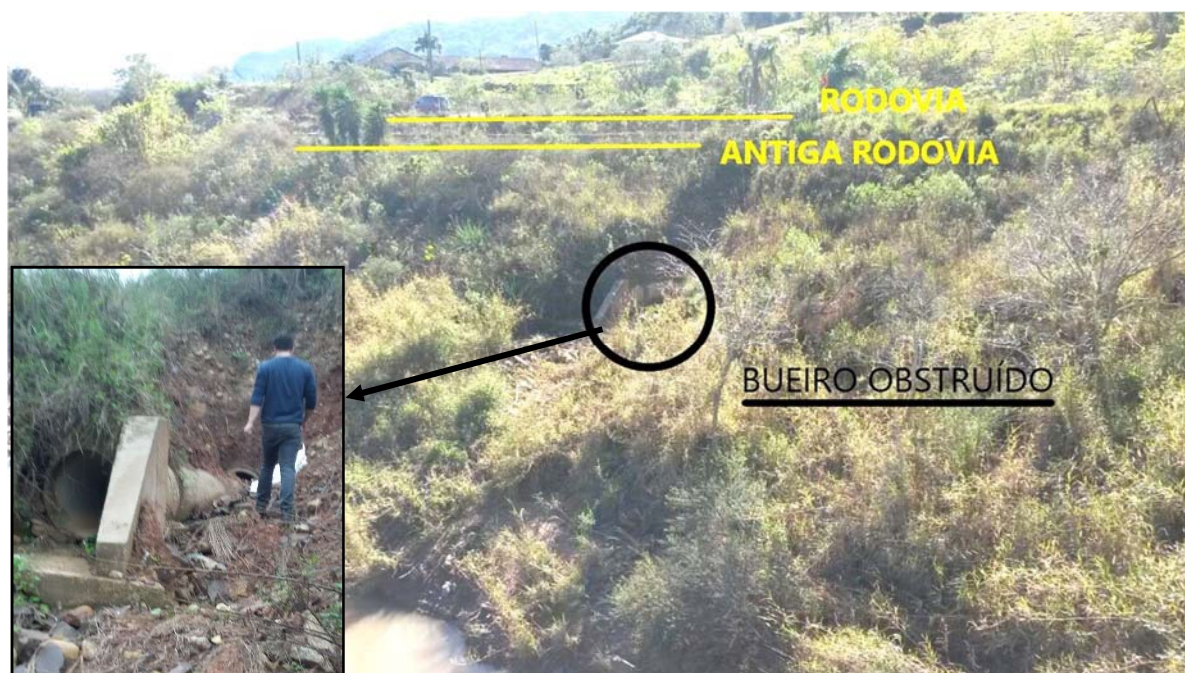
Figura 5.9 – Imagem do bueiro obstruído em setembro de 2017. No detalhe é possível observar parte deslocada do mesmo.
