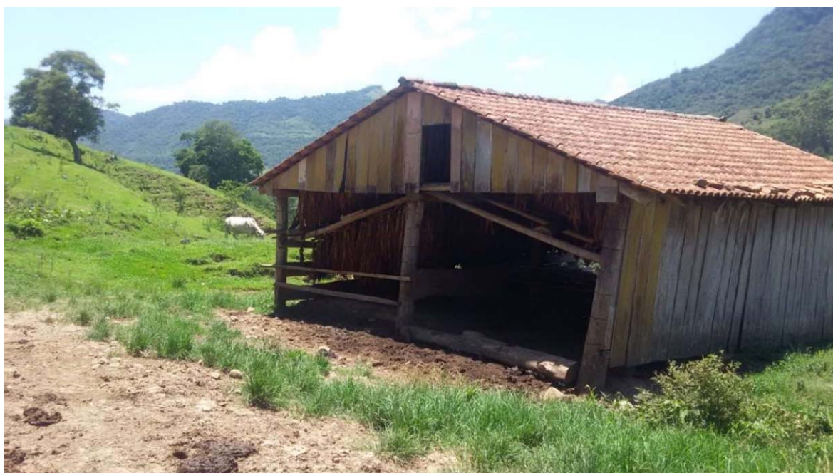
Figura 5.6 – Construção com paredes inclinadas, indicando a movimentação do solo onde está construído. Evidências de rastejo ao fundo da imagem.
