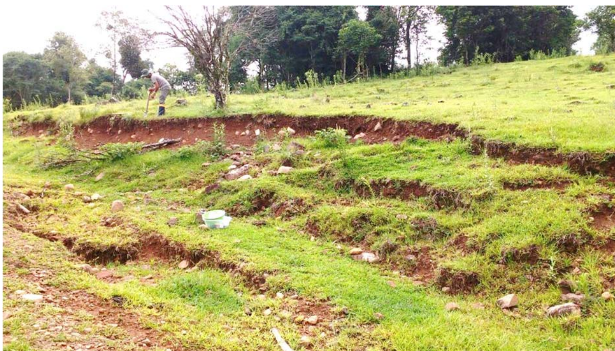
Figura 5.11 – Encosta em fevereiro de 2018; meses após a conclusão da obra. A região continuou se movimentando.
