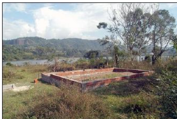
FIGURA 06 - Fragrante de crime ambiental numa construção em área imprópria, Microbacia do Vacacaí-Mirim, Santa Maria, RS - 2005
