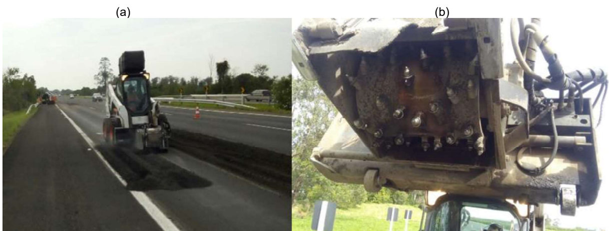
Figura 23 – Equipamento realizando serviço de fresagem (a) e detalhe do tambor de fresagem (b)
