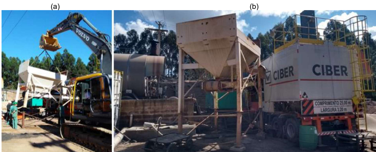
Figura 49 – Instalação (a) e posicionamento do silo alimentador de RAP em relação a usina (b)
