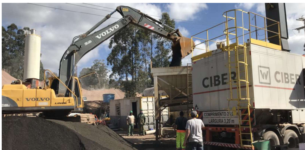
Figura 51 – Alimentação do silo de RAP
