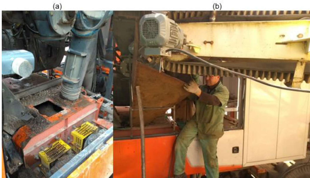
Figura 50 – Detalhe da entrada do RAP: abertura superior (a) e calha instalada no final da correia (b)
