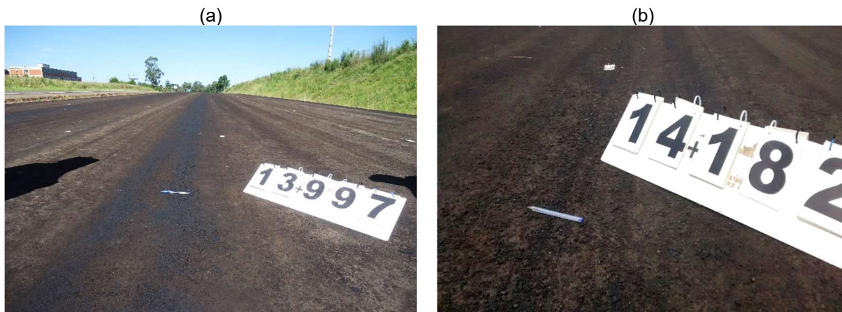
Figura 72 – (a) Superfície com marcas de imprimação e marcas de pneus de veículos e (b) Segregação do material empregado na camada (BGS) no segmento da BR-287/RS desta pesquisa
