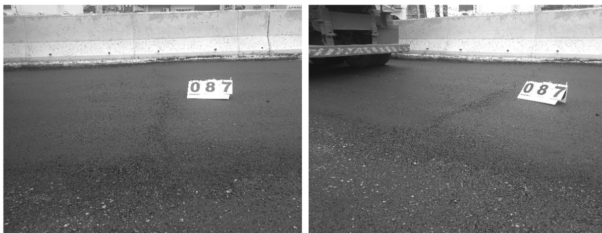
Figura 102 - Localização de junta transversal após conclusão do Trecho ERS-509 desta pesquisa
