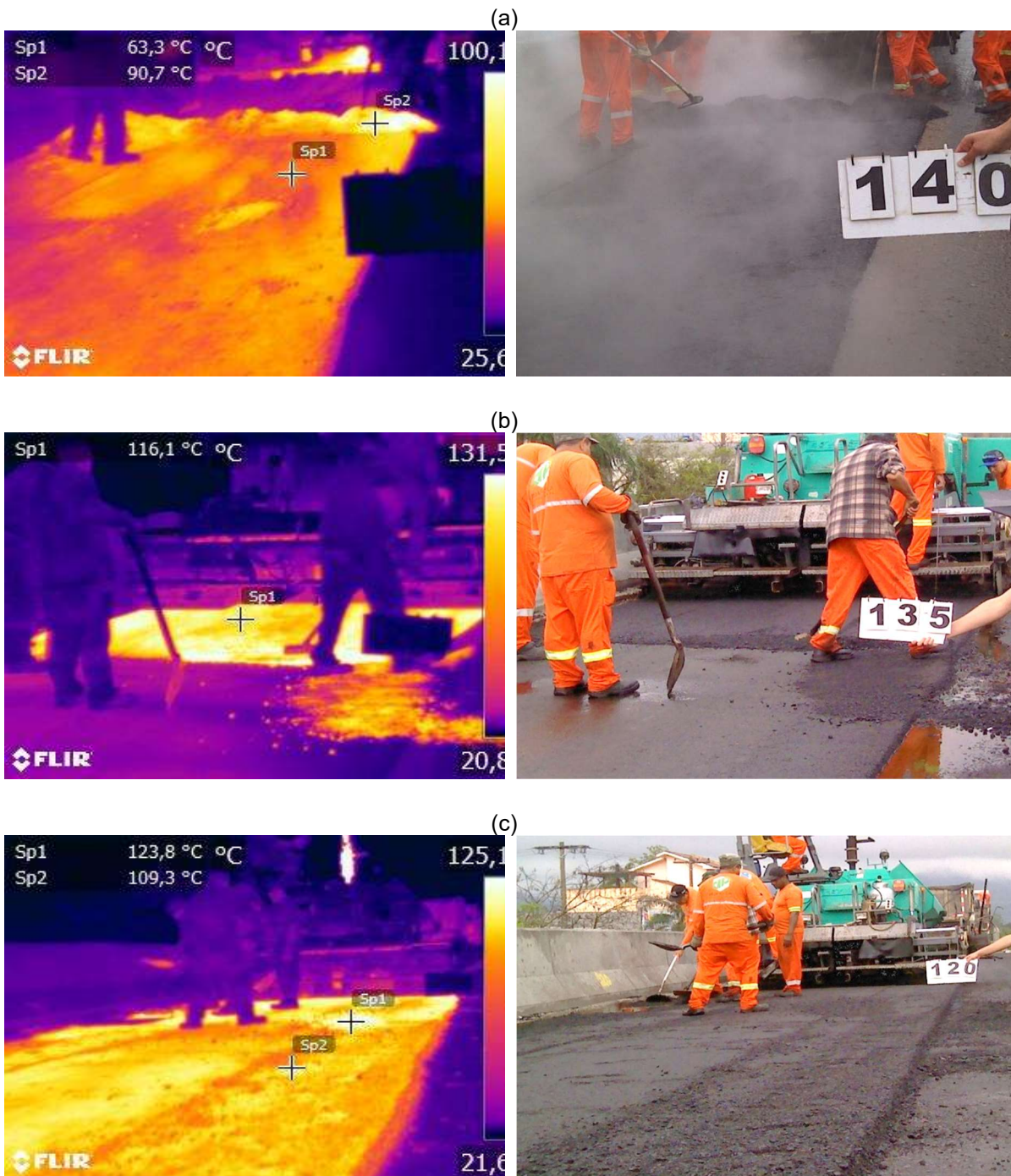
Figura 89- Segmento executado com chuva (a) paralização dos serviços devido à forte chuva - junta transversal. (b) retomada dos serviços com massa fria – (116°C) inferior a recomendação de projeto. (c) diferenciais de temperatura e temperatura inferior a recomendação de projeto. Trecho ERS-509 desta pesquisa
