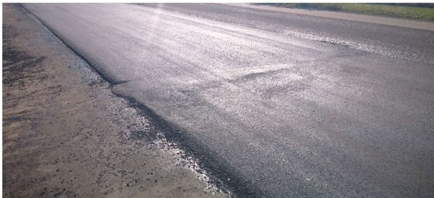
Figura 130 - Junta finalizada sem o devido acabamento – Localização 282 no Trecho da BR-392 desta pesquisa
