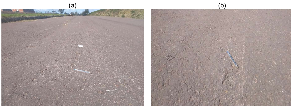
Figura 78 – Superfície com marcas de impacto devido à descarga de peças pré-moldadas. (a) TR 02 – Segmento 4 e (b) TR 02 – Segmento 5 – Trecho BR-287/RS desta pesquisa. Fotografias registradas em Julho/18
