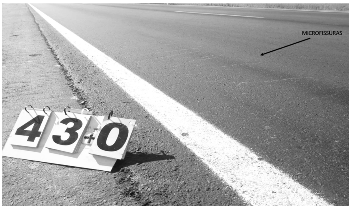
Figura 143 - Defeitos em fase inicial – microfissuras no Trecho BR-392/RS desta pesquisa
