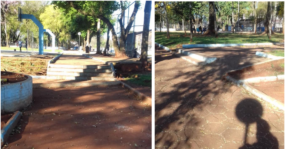
Figura 36 – Desníveis da quadra de referência 05
