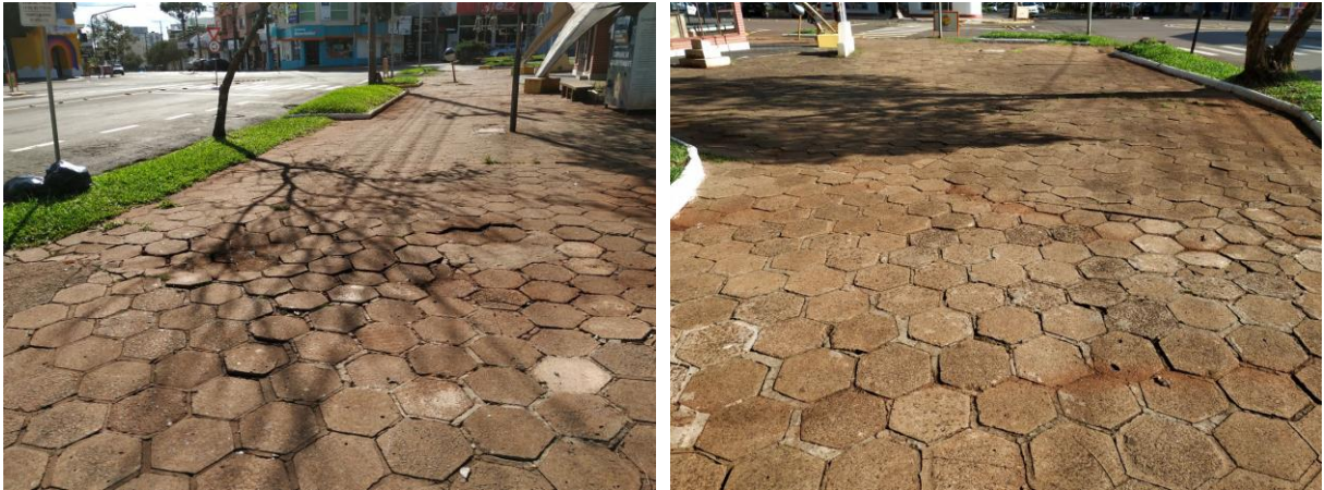
Figura 22 – Condições do piso da quadra de referência 01
