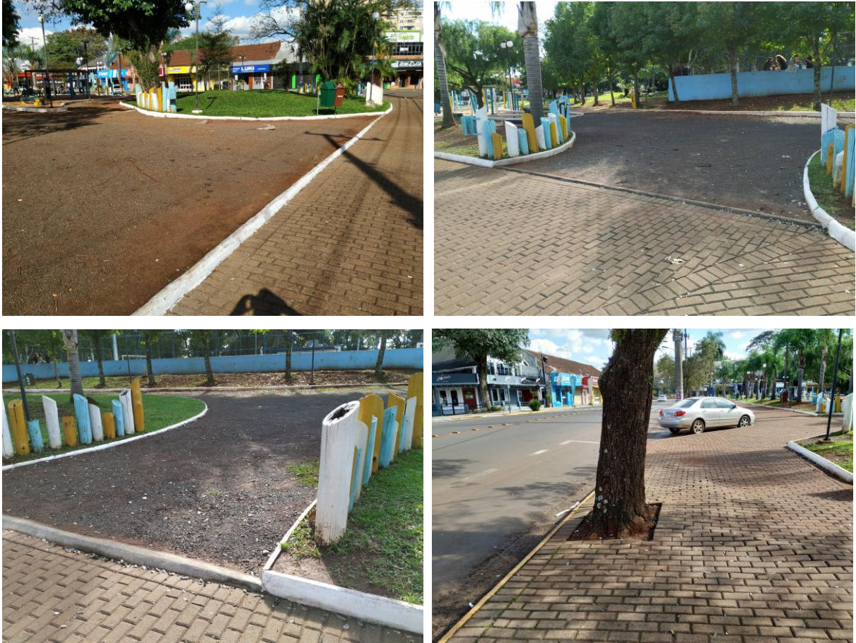
Figura 28 – Condições de piso na quadra de referência 03
