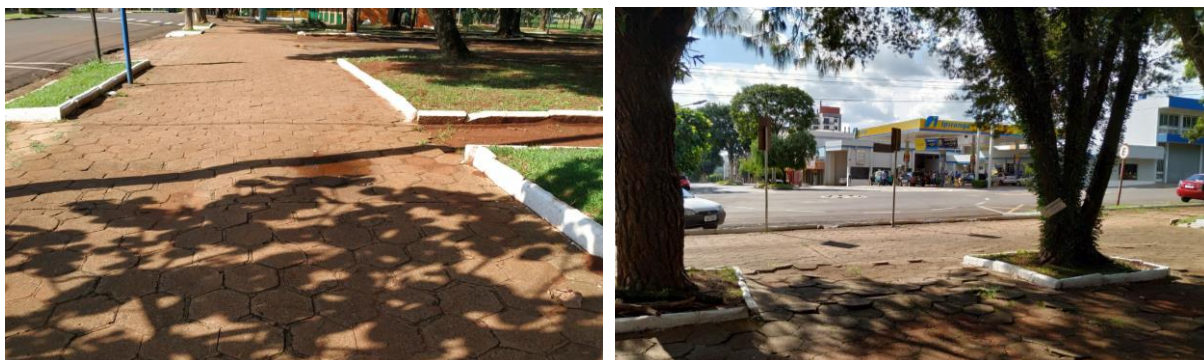
Figura 32 – Condições do piso da quadra de referência 04
