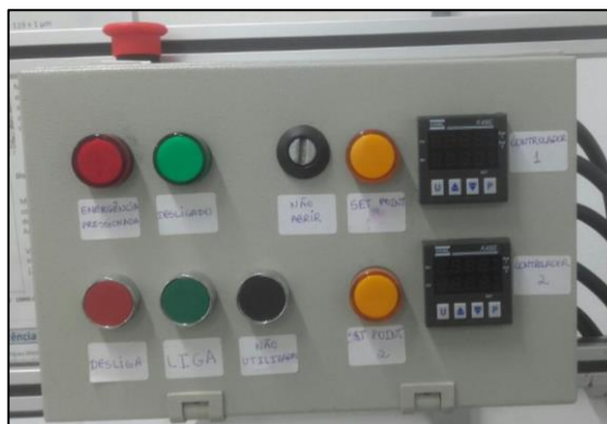
Figura 4 - Controlador de temperatura da unidade multipropósito
