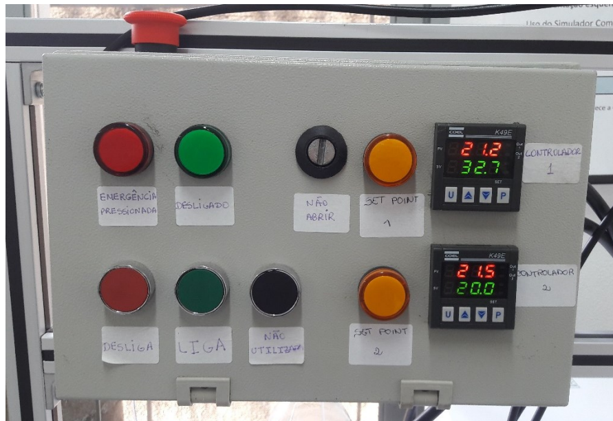
Figura 8-Quadro de controle com o controlador Coel K49e
