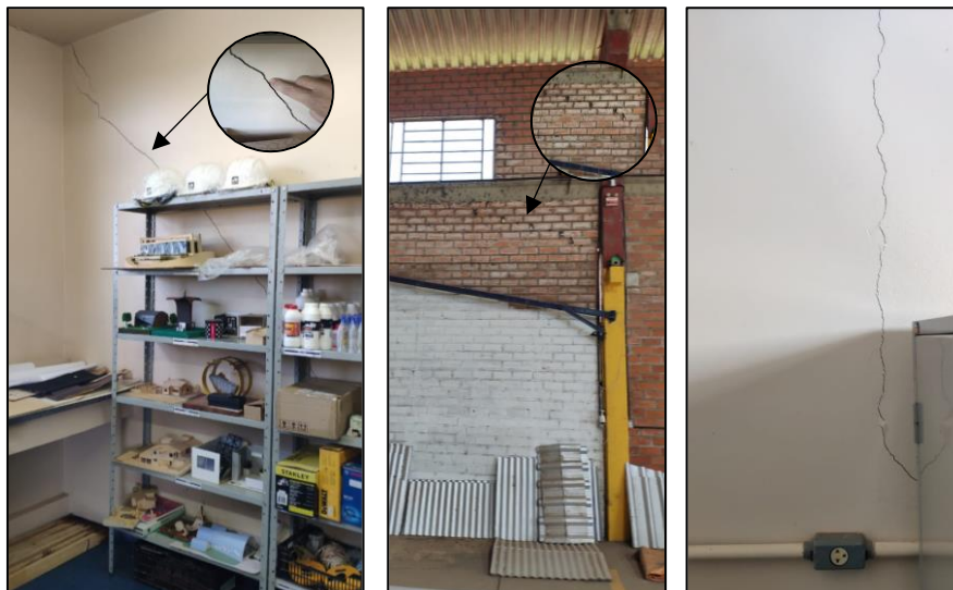
Figura 3.8- Trincas em edificações possivelmente geradas pelo fenômeno de colapso no solo.
