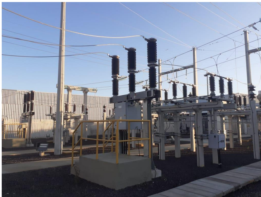
Figura 14 - Disjuntor de alta tensão.
