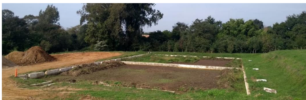
Figura 6 - Tanque de secagem do lodo de esgoto.
