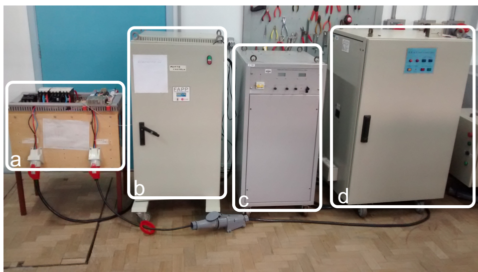
Figura C.1 – Visão geral do protótipo: (a) indutores para ensaios de variação paramétrica, (b) inversor e filtro LCL, (c) fonte de alimentação CC e (d) VARIAC para conexão com a rede elétrica.
