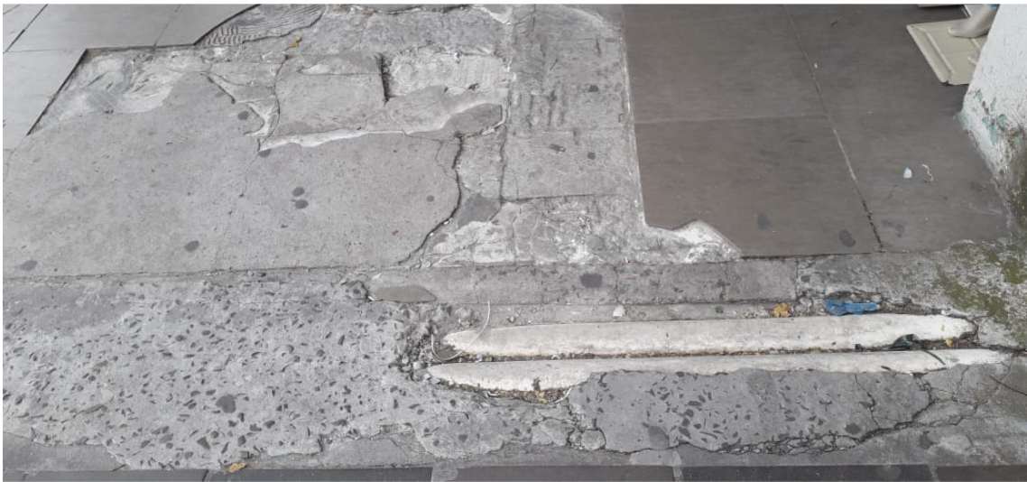
Figura 28 – Irregularidade na calçada no segmento 10.
