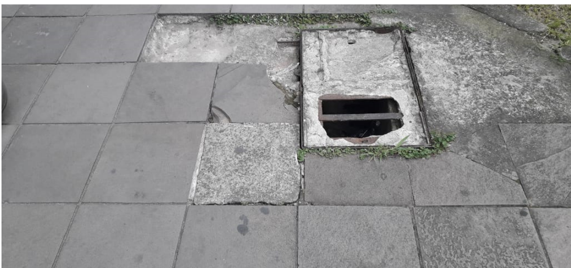
Figura 27 – Buraco no segmento 1a.
