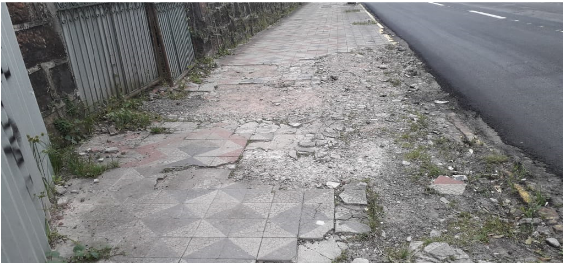
Figura 29 – Trecho crítico do passeio no segmento 7.
