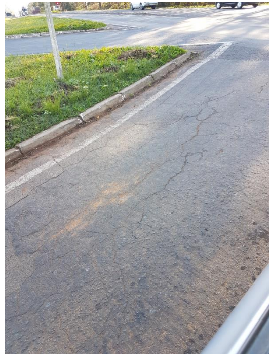
Figura 32 - Condição do pavimento próximo ao trevo junto à BR-158
