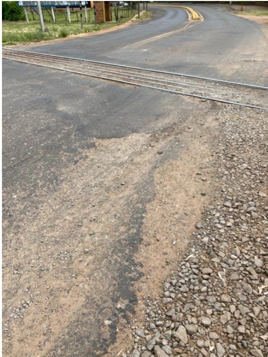
Figura 31 - Condição do pavimento próximo aos trilhos na entrada de Tupanciretã
