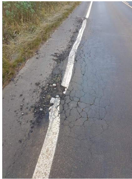
Figura 30 – Escorregamento e fissuras
