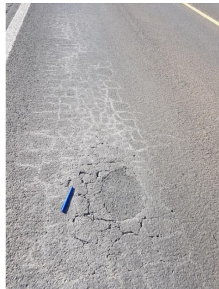
Figura 29 – Fissuras e bombeamento de finos
