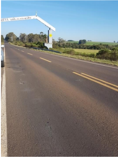
Figura 26 – Exsudação e fissuras FC-2 na entrada da RS-392
