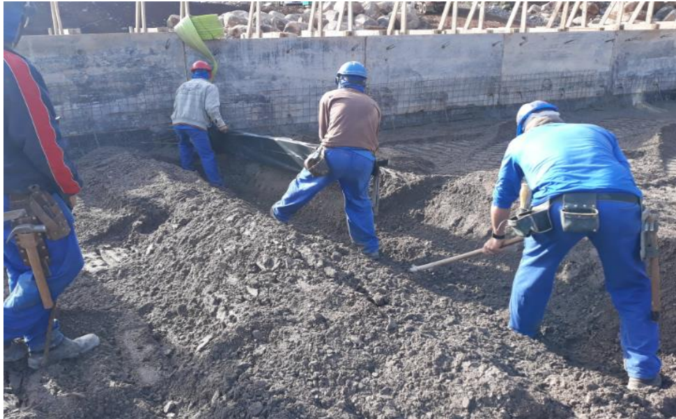
Figura 32 - Abertura de vala para inserção de lona Neoprene no correr da junta de dilatação
