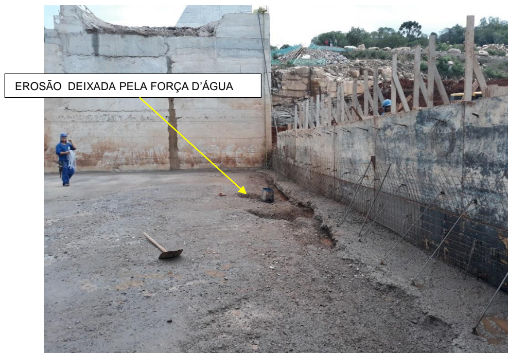
Figura 36 - Camada de CCR erodida pelas ação da água
