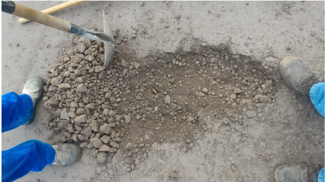
Figura 37 - Situação de camada com má compactada
