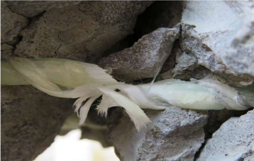
Figura 23: Detalhe da ruptura da barra de PRFV.
