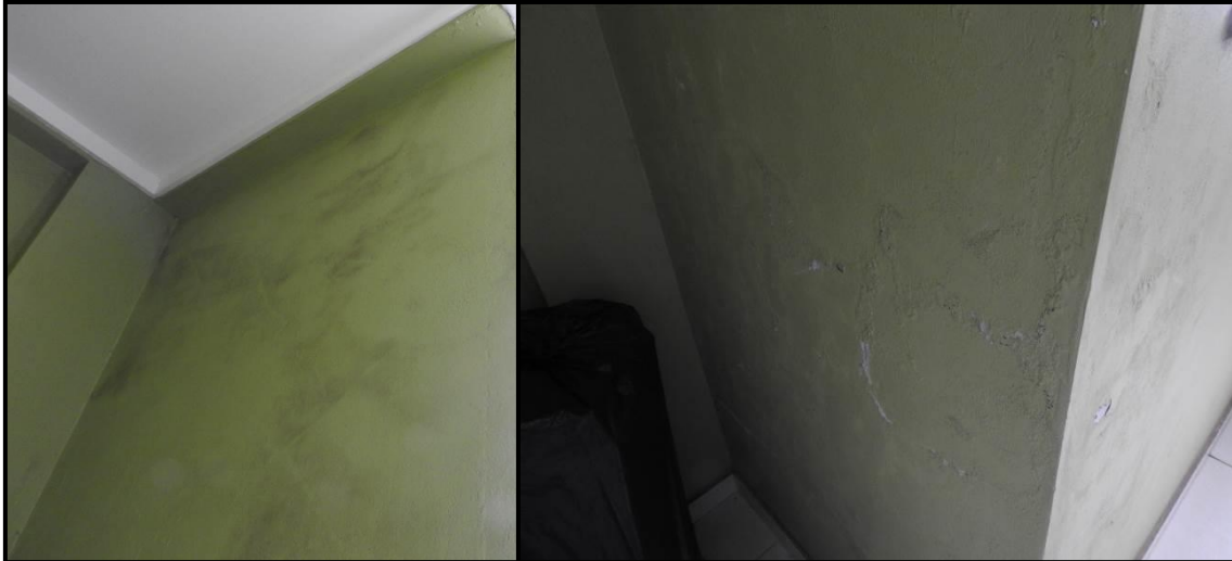
Figura 12 – Presença de mofo e bolhas no revestimento interno
