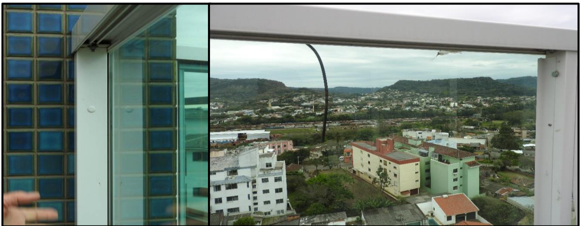
Figura 32 – Fixação do vidro pelo lado externo, borracha de fixação solta
