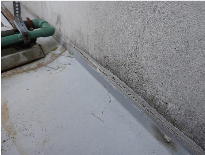
Figura 28 – Fissuras na vedação de algeroz
