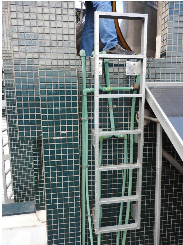
Figura 34 – Escada tipo marinheiro irregular
