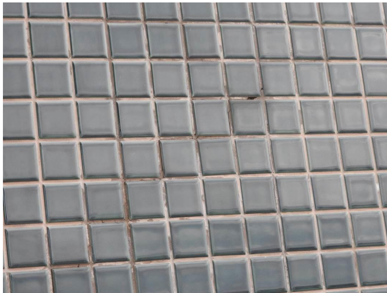
Figura 11 – Eflorescência no rejuntamento do revestimento cerâmico
