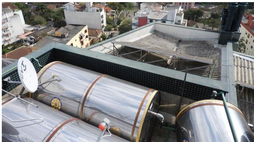
Figura 30 – Local de instalação dos reservatórios de água quente
