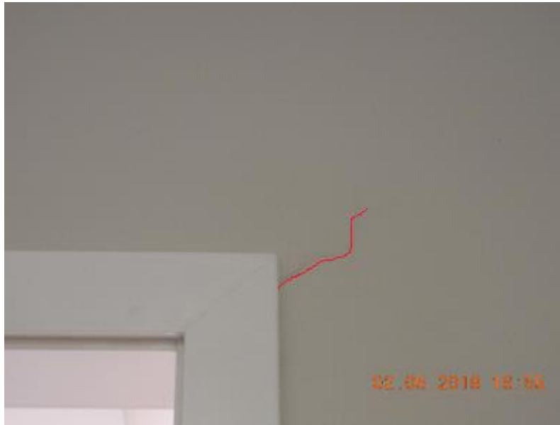
Figura 20 – Fissura em 45 graus devido à ausência de verga
