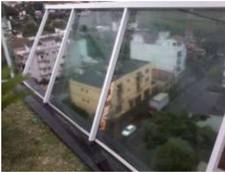
Figura 33 – Ruptura do guarda-corpo
