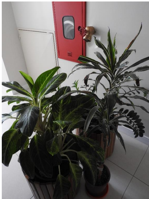
Figura 35 – Hidrante com acesso obstruído
