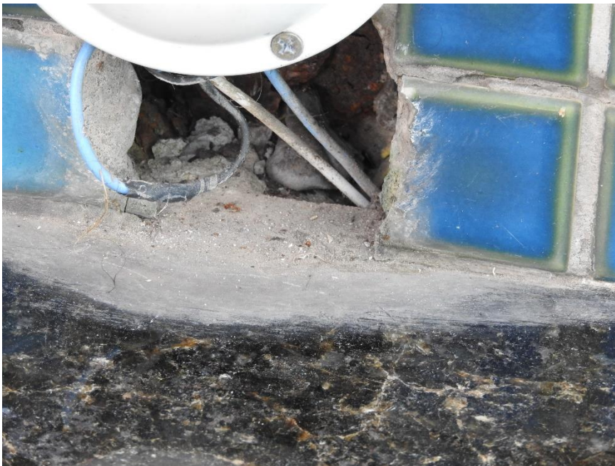
Figura 24 – Instalação inacabada de uma luminária na escada de acesso do edifício
