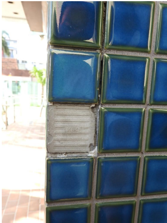
Figura 27 – Destacamento de pastilha cerâmica
