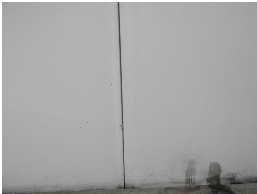
Figura 15 – Manifestação de umidade na parede da garagem
