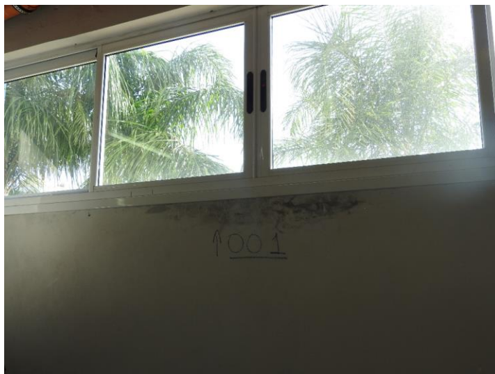
Figura 13 – Presença de mofo abaixo de esquadria na garagem
