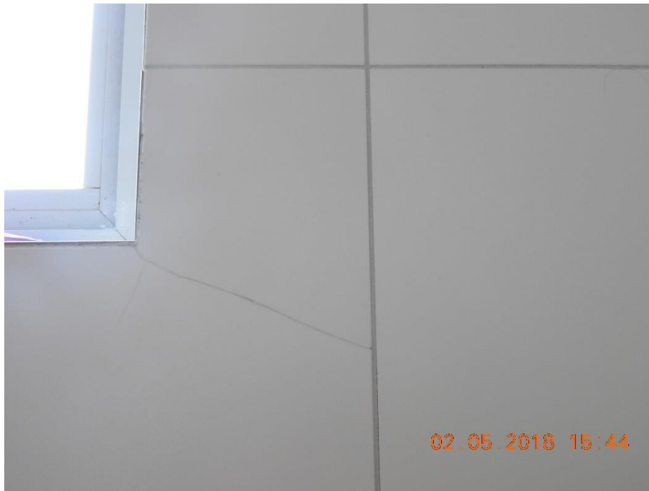
Figura 18 – Fissura devido à falta de contra-verga
