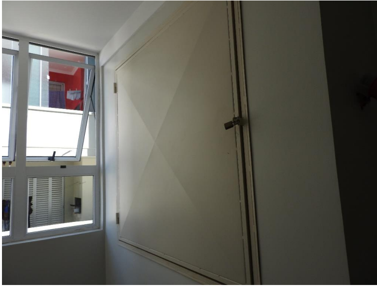
Figura 36 – Tubulação de gás permanece trancada
