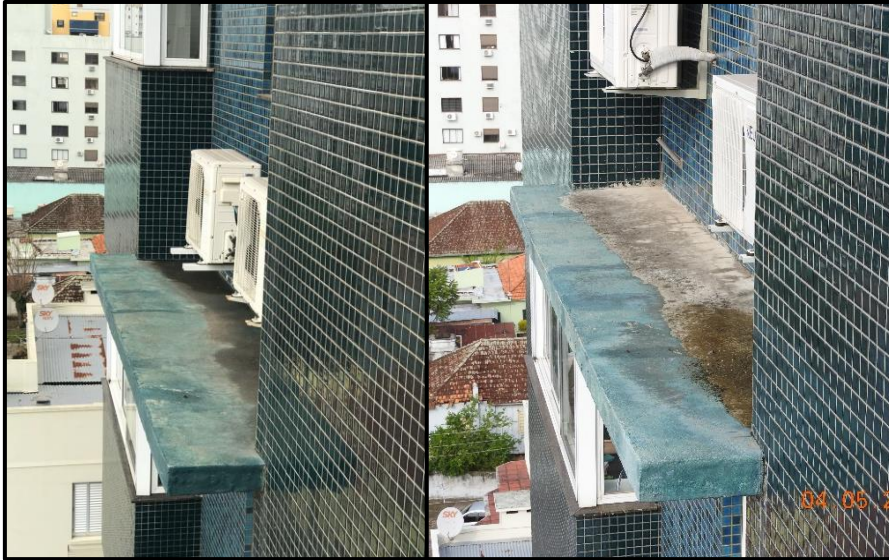
Figura 25 – Marquises com acúmulo de água
