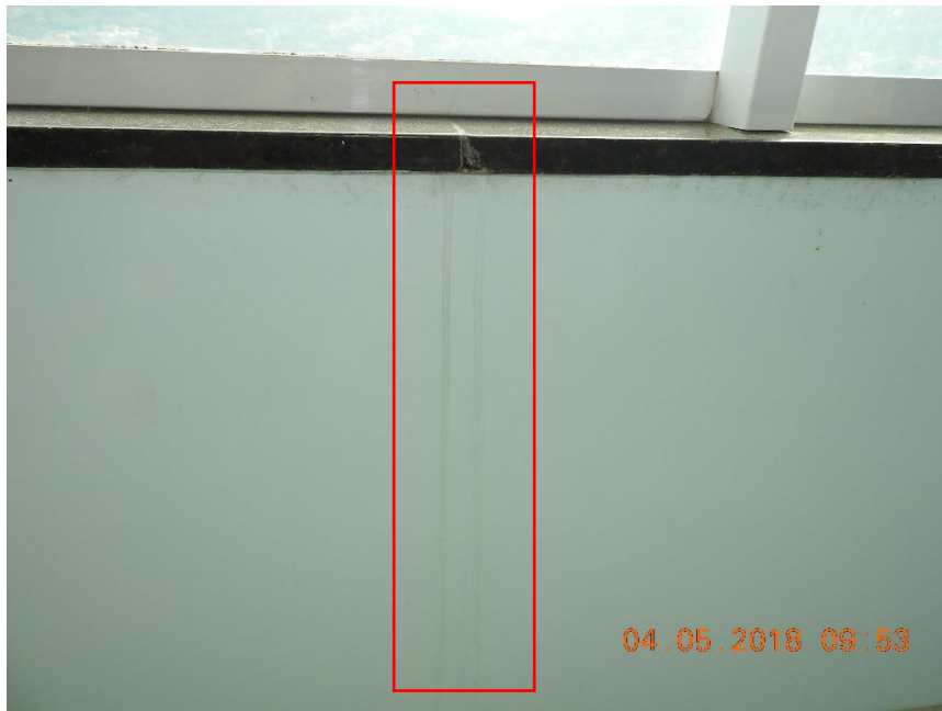
Figura 22 – Mancha de umidade abaixo da junta de dilatação da placa de granito na sacada
