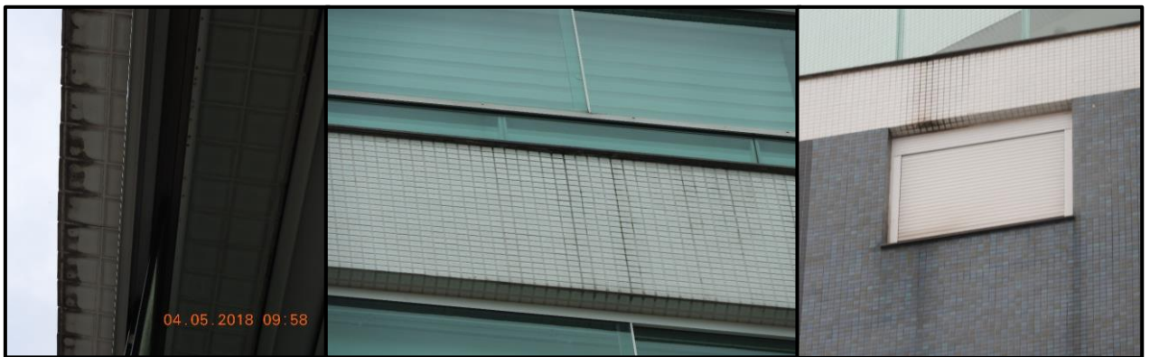
Figura 10 – Presença de manchas de umidade no revestimento externo
