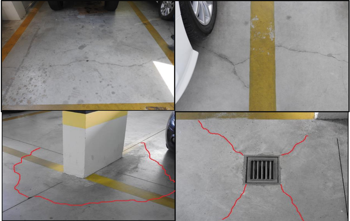
Figura 17 – Compilação de ocorrências de fissuras na garagem
