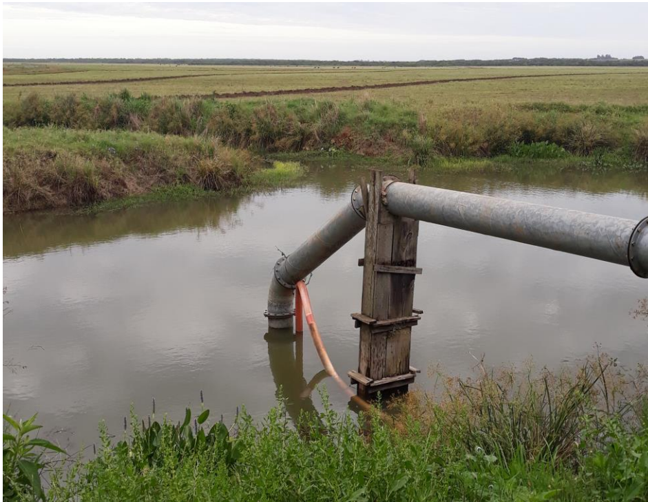
Figura 2.7 – Captação da água em uma fonte hídrica pela tubulação de sucção da bomba hidráulica – Início do levante em lavouras de arroz.
