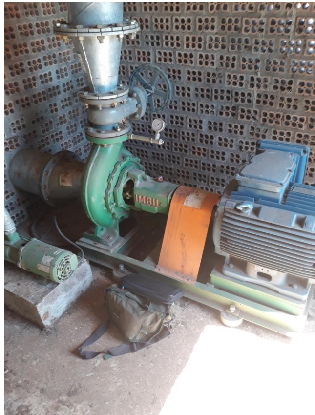
Figura 2.9 – Conjunto Bomba-Motor de um sistema de irrigação.
