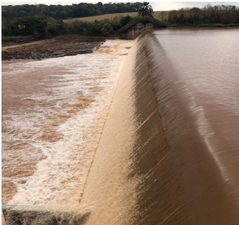
Figura 11 - PCH José Barasuol 14 MW, excesso de água verde pelo corpo da barragem.
