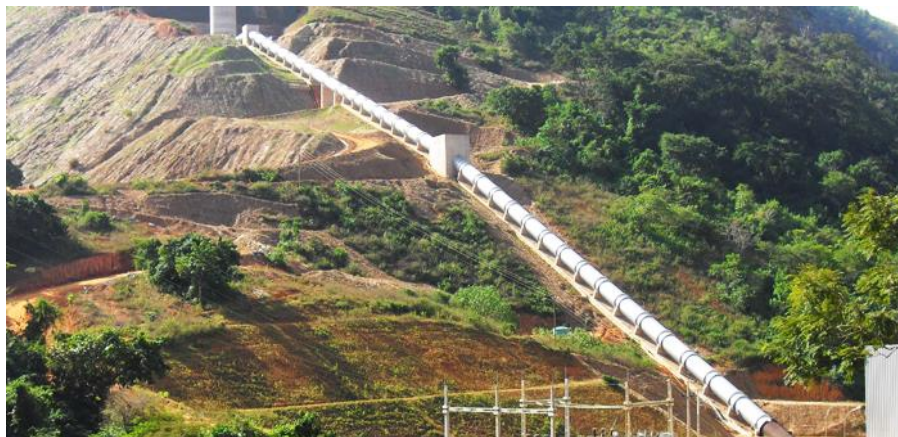
Figura 16- Conduto forçado da PCH Barra da Paciência - 23 MW.
