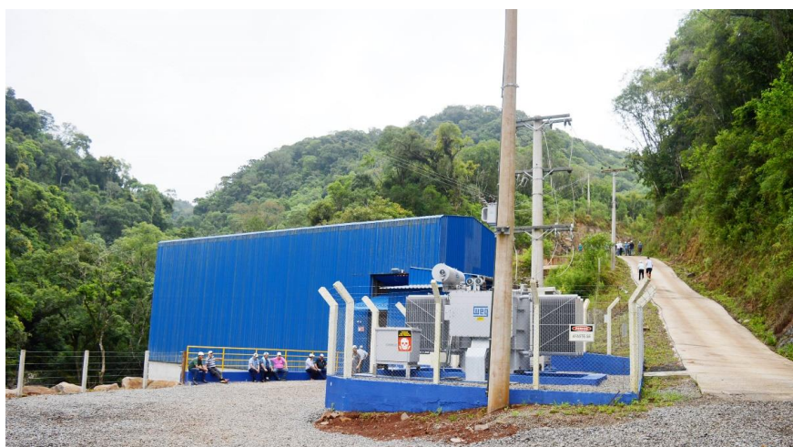
Figura 18 - Casa de força do Tipo exterior e abrigada da CGH Agudo 3,9 MW.
