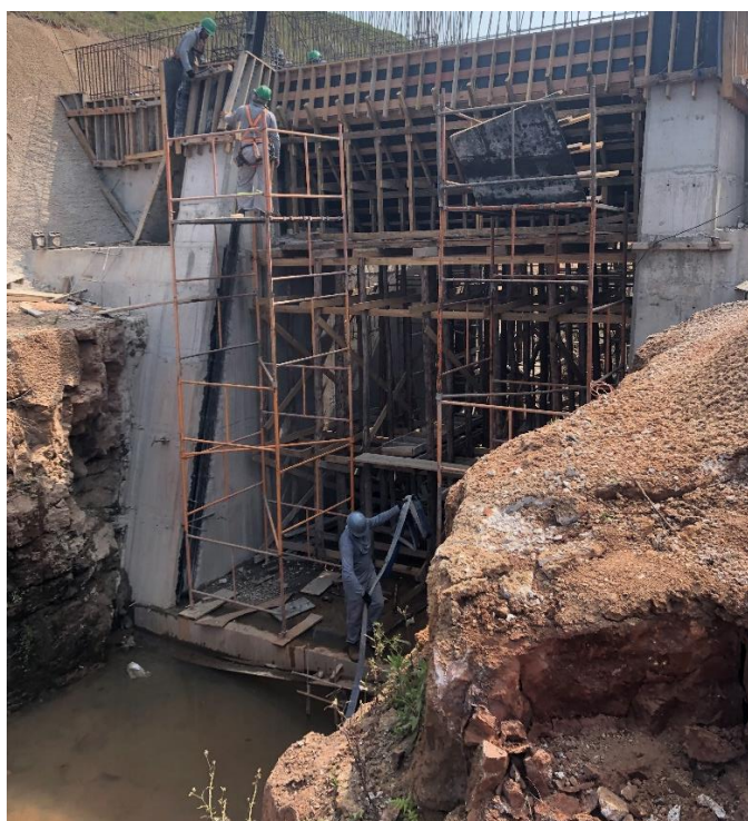
Figura 12 - Tomada d'água na fase de instalação da PCH.
