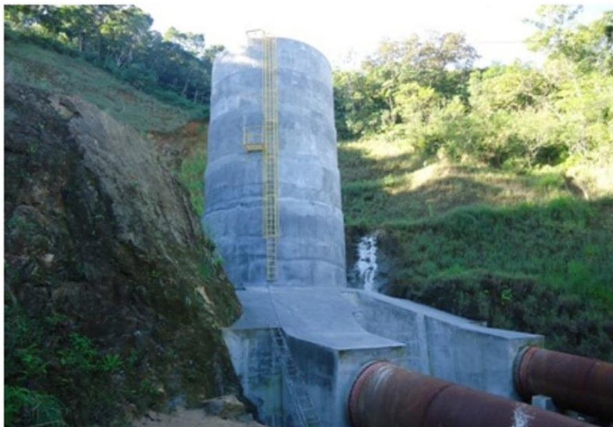
Figura 15 - Chaminé de Equilíbrio da PCH Nova Fátima - 4,1 MW, Santa Rosa de Lima- Santa Catarina.
