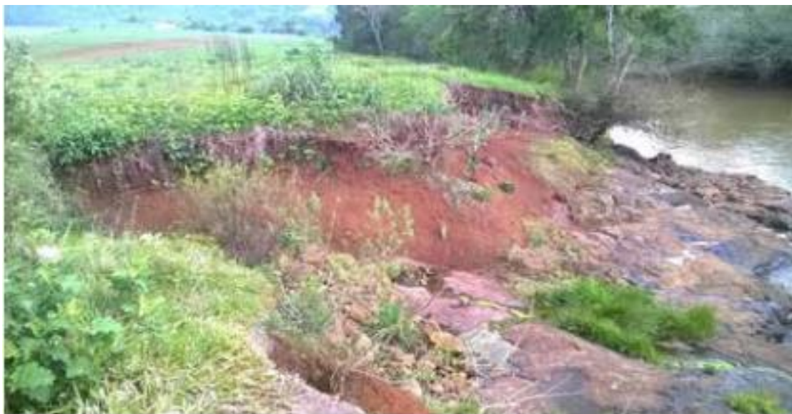
Figura 21 - Processos erosivos atuando na margem do barramento da CGH Granja Velha localizada em Taquaruçu do Sul- RS.
