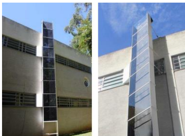
Figura 9 - Vista geral da chaminé solar e do sombreamento gerado
