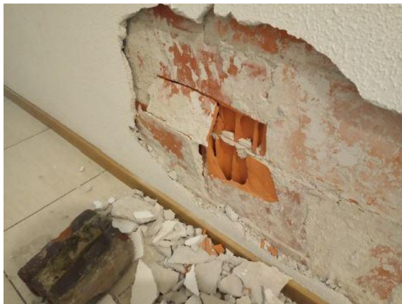
Figura 3.6 – Alvenaria esmagada na parede entre o corredor e o apartamento 201.
