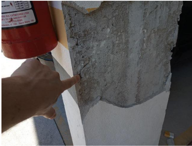
Figura 3.7 – Superfície do concreto do pilar P16.
