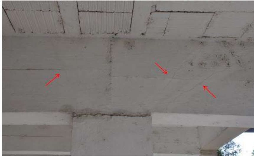
Figura 3.5 – Fissuras na viga V21, junto ao pilar P14.
