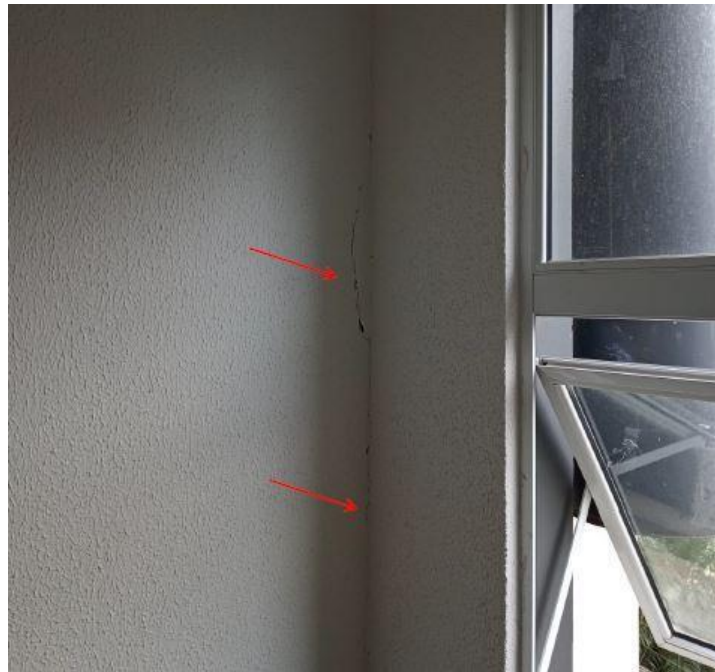
Figura 3.4 – Fissura na parede da caixa de escada.
