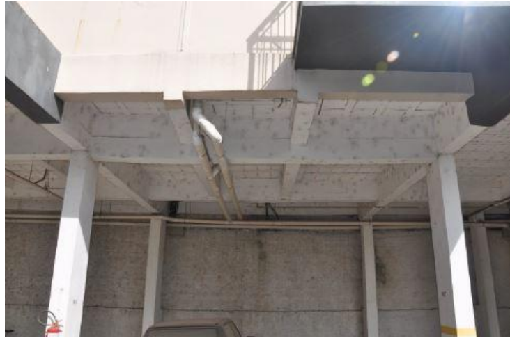
Figura 3.8 – Vigas V4, V6 e V12 com deformações visíveis.
