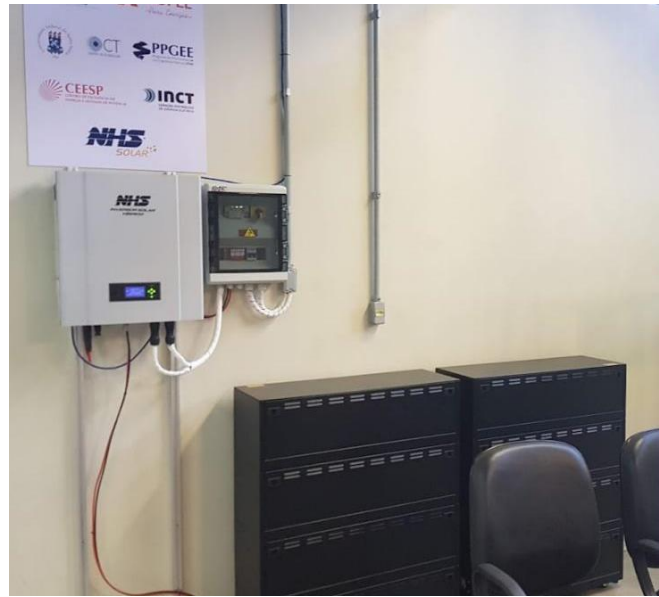
Figura 15 - Inversor NHS instalado em laboratório da UFSM com 2 bancos de bateria de chumbo-ácido
