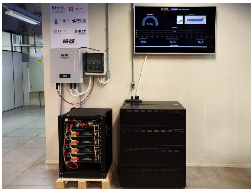
Figura 28 - Visão geral da instalação no NUPEDDEE
