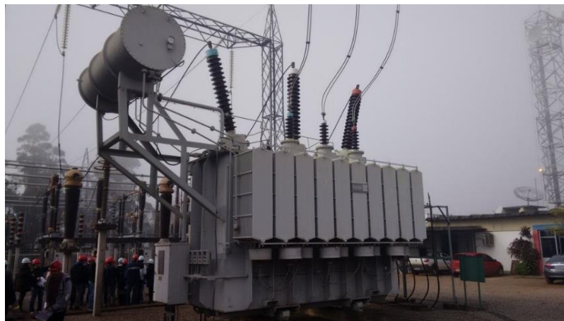
Figura 1 – Transformador de potência
