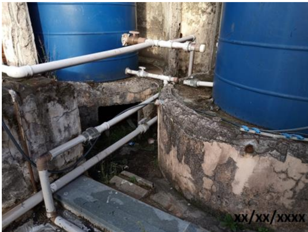
Figura 07 – Degradação das lajes de apoio dos reservatórios
