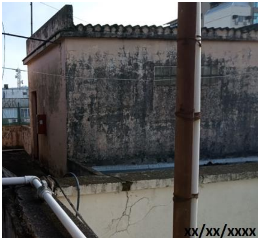
Figura 06 – Degradação das paredes de abrigo dos reservatórios.
