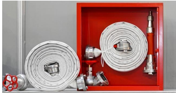
Figura 7 – Hidrante de parede e seus componentes
