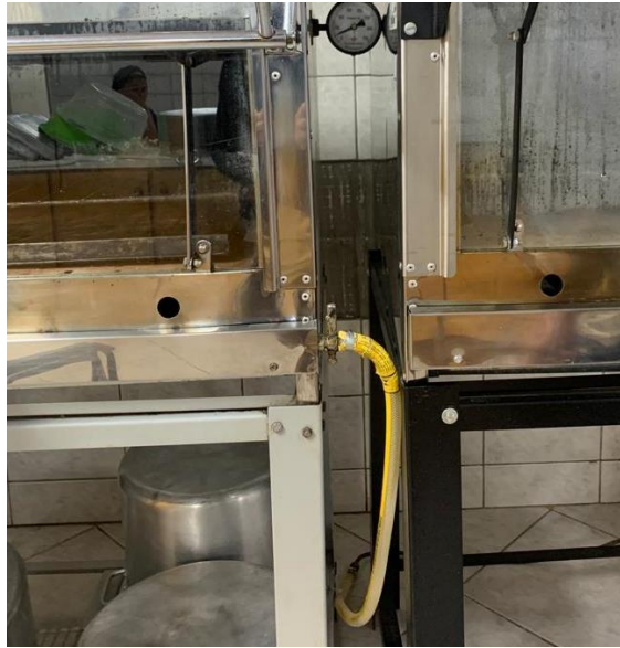
Figura 19 – Colisão da tubulação de gás e forno existente
