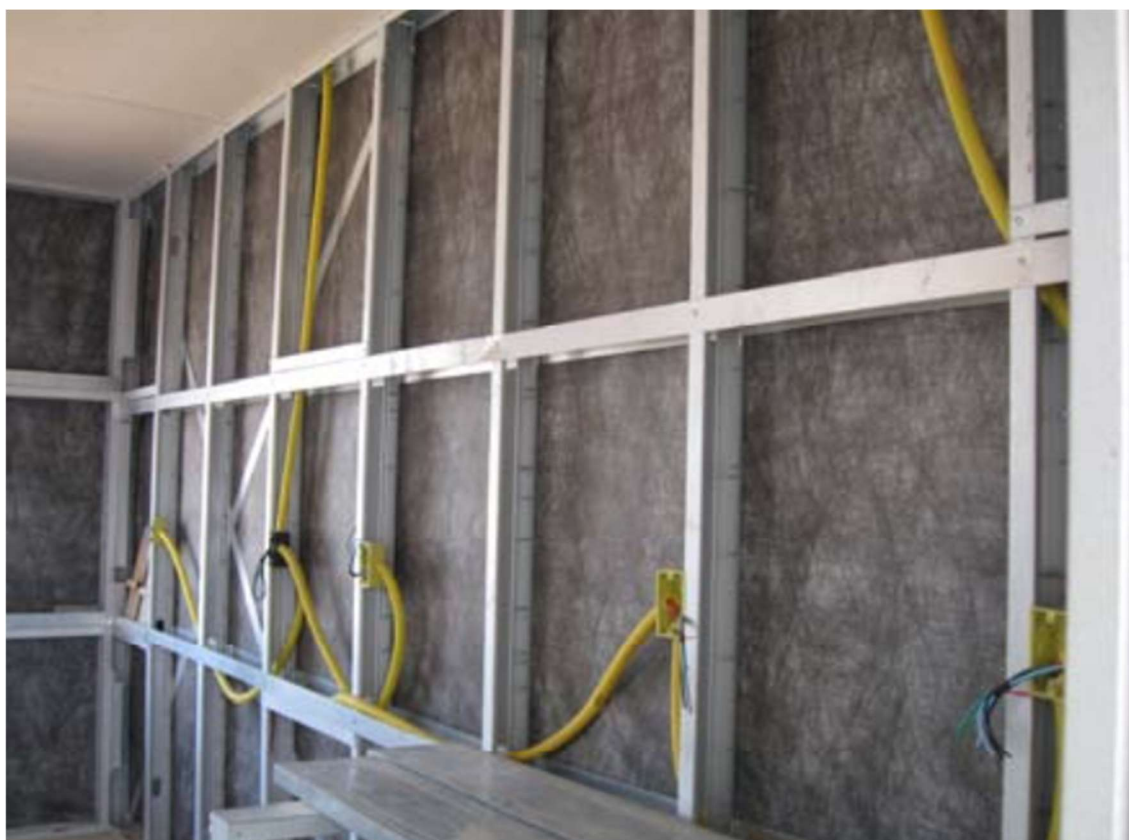
Figura 19 - Instalações elétricas em painel de LSF
