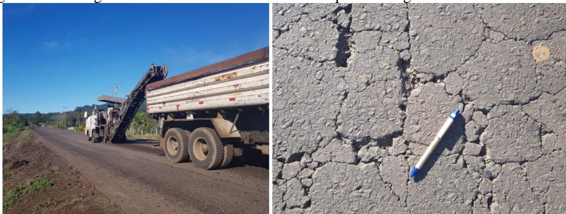
Figura 58 - Fresagem e estado visual do revestimento que deu origem ao Neat RAP
