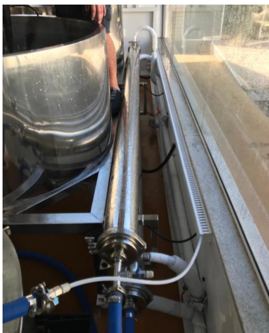
Figura 11 - Resfriadores casco-tubulares usados no resfriamento do mosto. O resfriador inferior é o de entrada com circulação de água, e o superior com circulação de etanol a -7°C.
