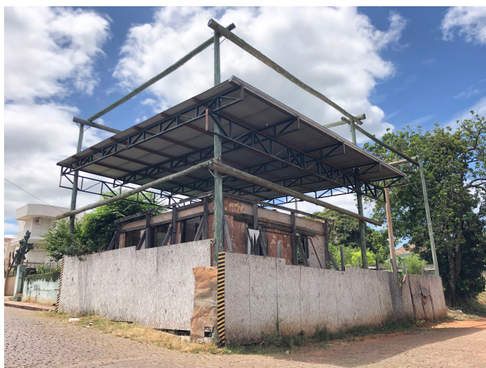
Figura 2 — Casa da Aldeia na condição em que se encontra desde 2009, coberta por uma estrutura de metal e isolada por tapumes de madeira
