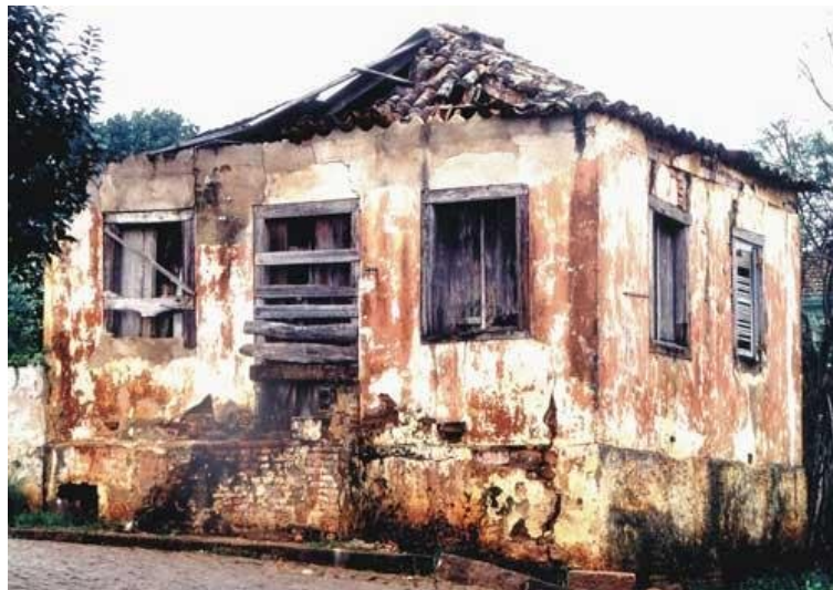
Figura 1 — Casa da Aldeia, exemplar da arquitetura luso-brasileira do século XIX, construída em 1849, já bastante degradada pela ação do tempo e pela falta de cuidados
