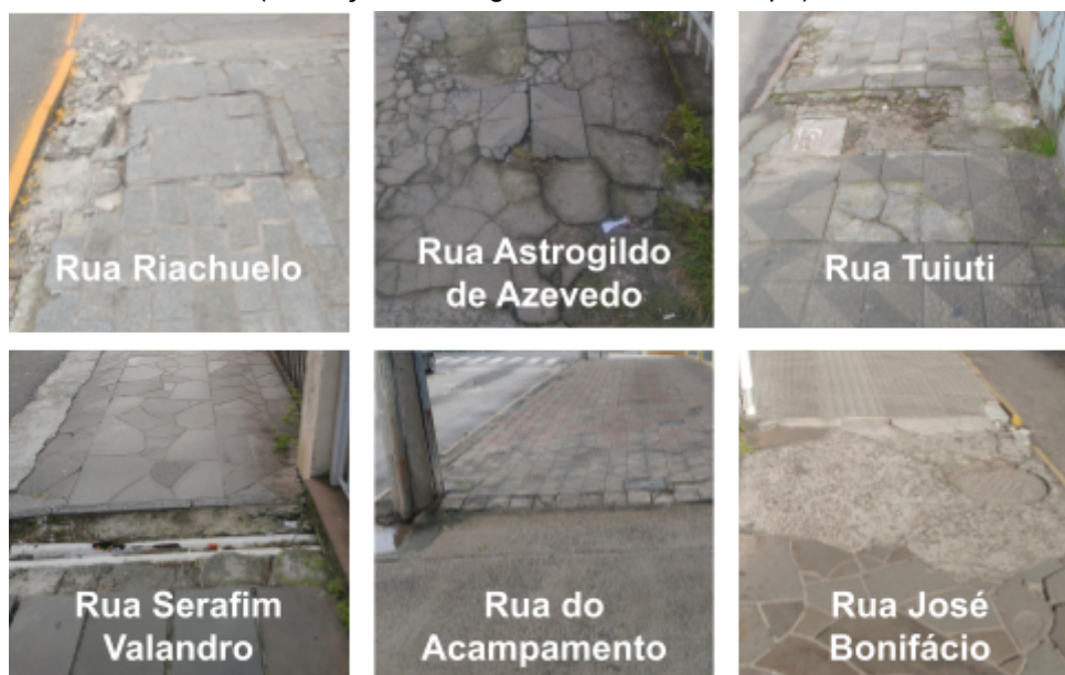
Figura 46 - Trechos com buracos, irregularidades, degraus e desníveis (descrição da imagem em nota de rodapé) 68
