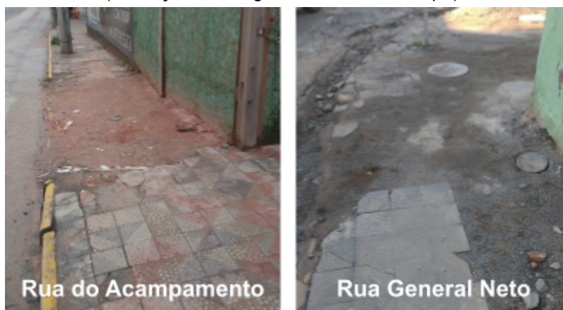
Figura 40 - Trechos com ausência de pavimentação nas calçadas (descrição da imagem em nota de rodapé) 62
