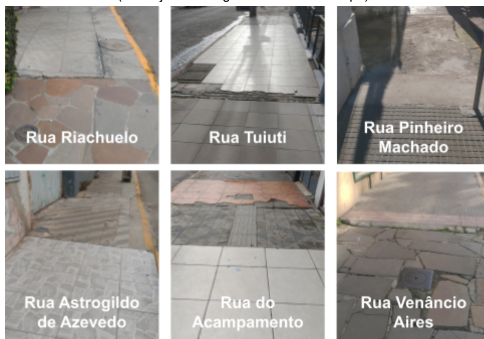
Figura 43 - Trechos com pavimentação derrapante, sem continuidade ou sem padronização (descrição da imagem em nota de rodapé) 65
