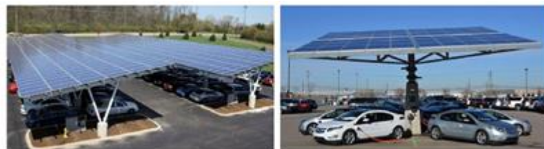
Figura 3 - Exemplo de garagens solares para a recarga de VEs.
