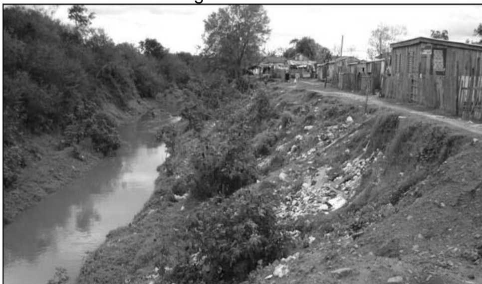
Figura 6 - Moradia que está em risco médio e alto de erosão de margem – Vila Lúdia
