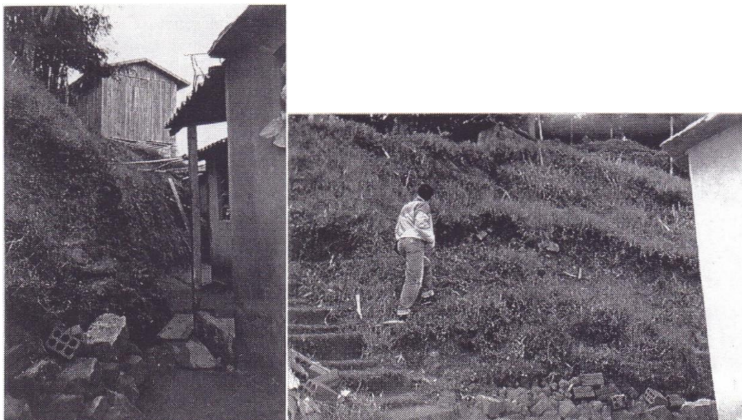
Fotografia 09 e 10 - Cicatriz de escorregamento
