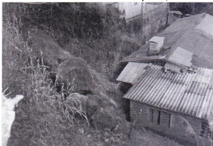
Figura 4 - Blocos de rocha com risco de queda, Vila Bilibiu 03/2000
