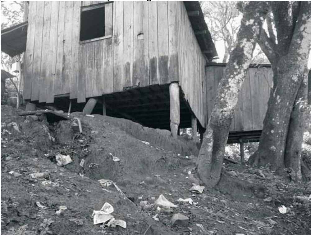
Figura 8. Fotografia da incidência de erosão linear provocada por concentração de água servida no terreno.
