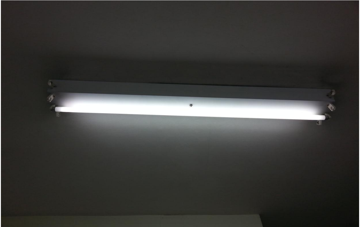
Figura 1 – Iluminação inadequada na sala para o preparo dos medicamentos, sendo mais evidente à noite.
