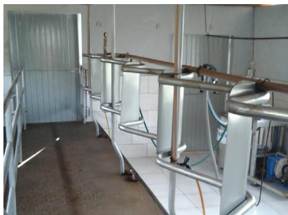
Figura 1 - Estrutura de ordenha
