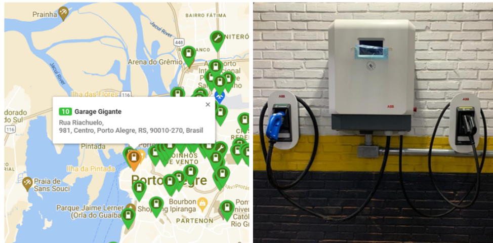
Figura 48 – Carregadores Terra Wallbox de 24 kW instalados na Garage Gigante de Porto Alegre.
