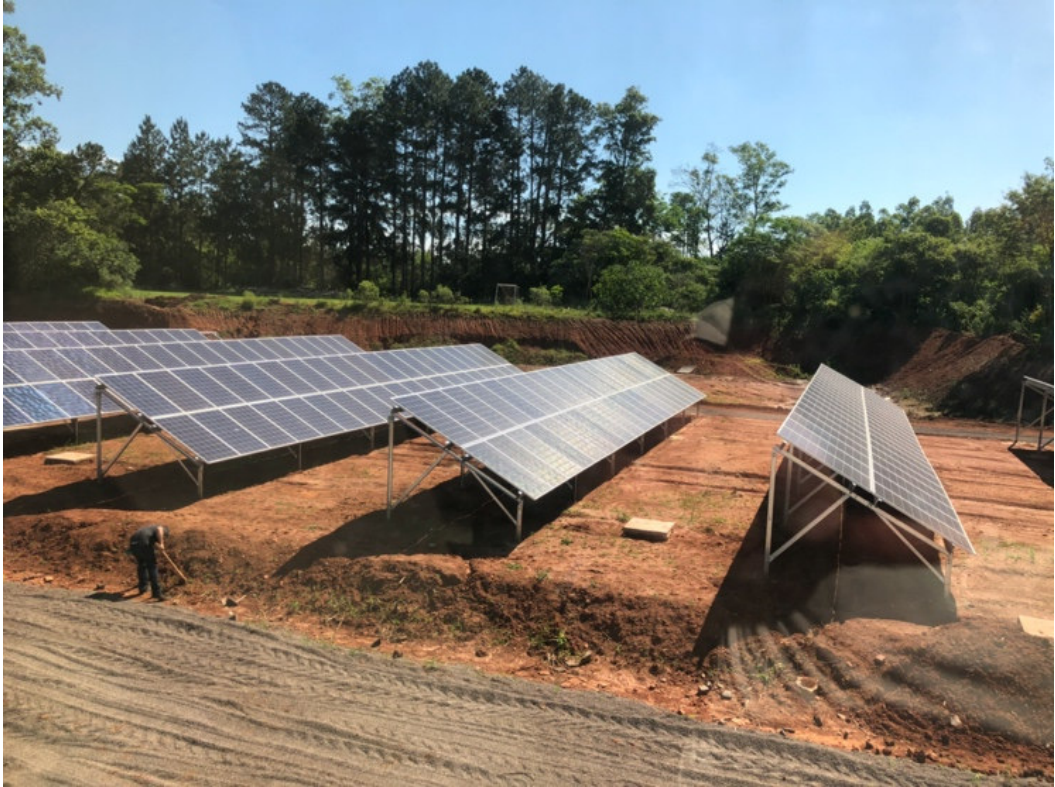
Figura 19 - Planta de Minigeração Solar Fotovoltaica
