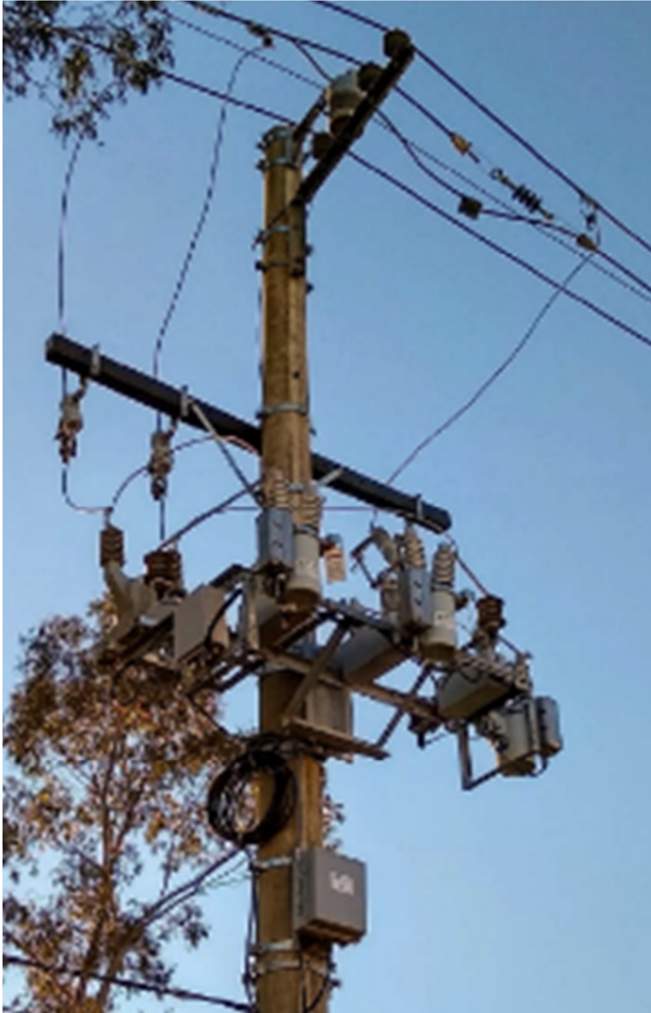
Figura 27 - Banco de Capacitores instalado na UFSM
