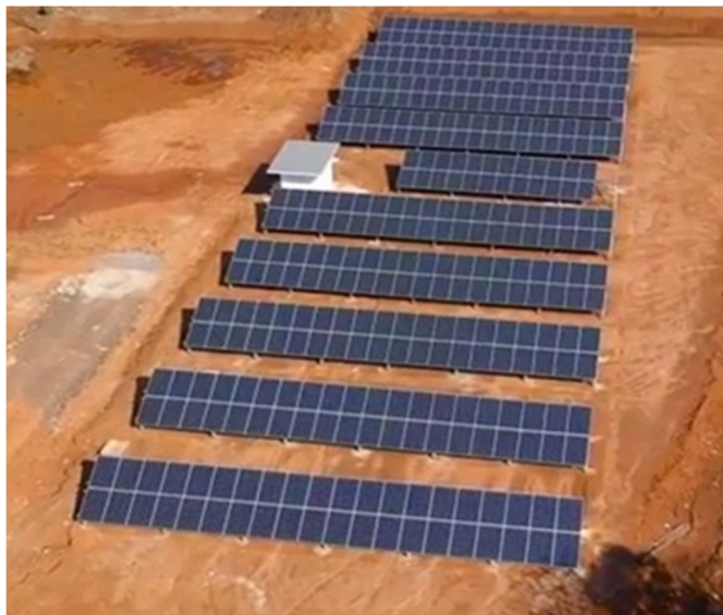
Figura 24 - Planta de Minigeração Solar Fotovoltaica Fonte: Beltrame, R. C. (2018)
