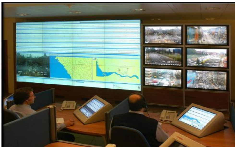
Figura 8 – Centro de Controle com as estações de trabalho e a parede de vídeo
