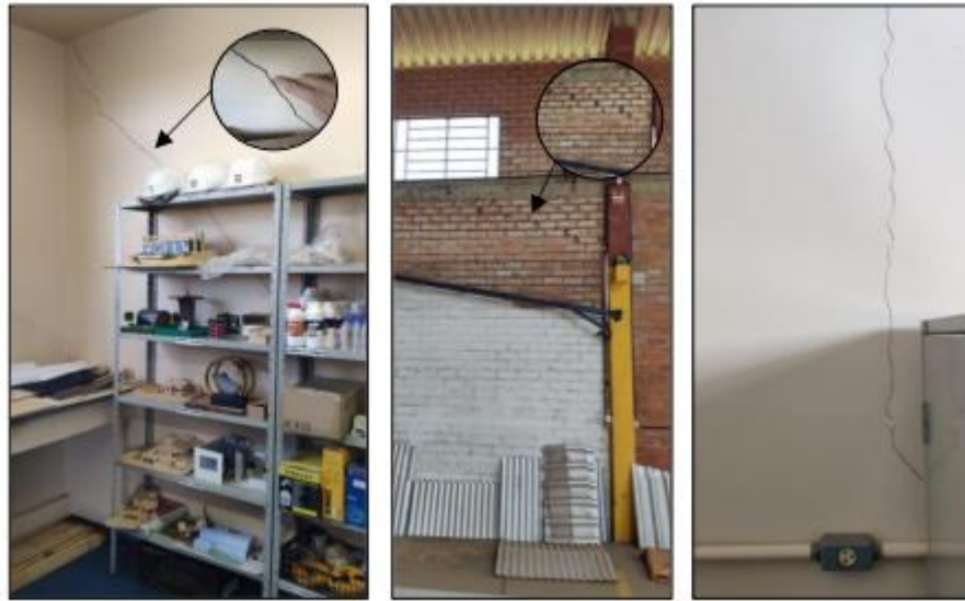
Figura 7– Trincas em obras civis do município de Cruz Alta-RS.
