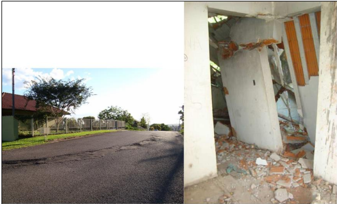
FIGURA 14. Trinca na rua Dr. Álvaro Correa e aspecto de uma moradia com sérios danos.
