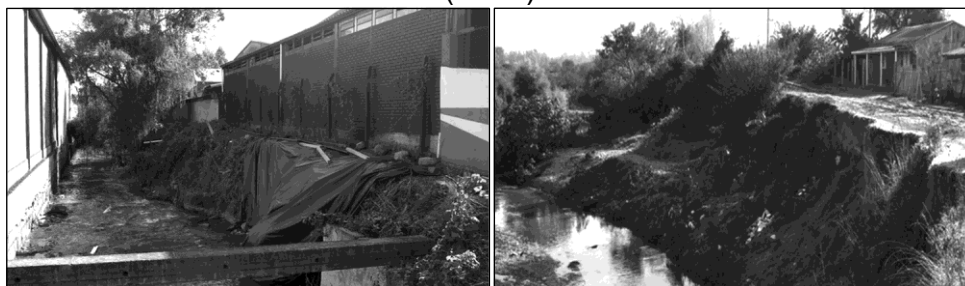
Figura 9 - Ocupação de margem de arroio com processo de erosão de margem no município de Caxias do Sul (A) (2010) e no município de Santa Maria (B) (2010)
