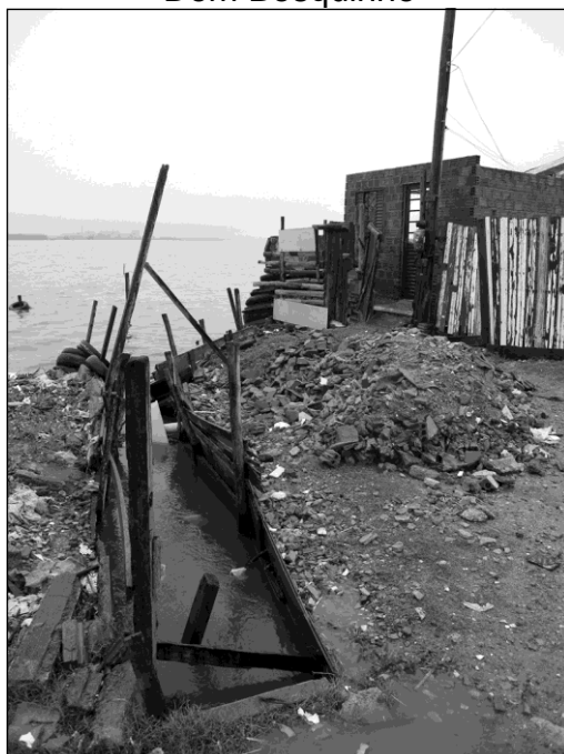
Figura 7 - Aterros consolidados e preparação para um novo, a oeste da vila Dom Bosquinho
