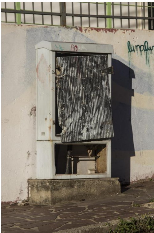
Figura 49 — Armário da rede telefônica em mal estado de conservação
