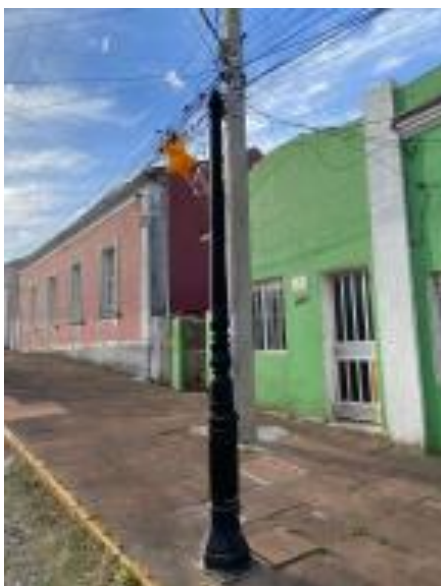
Figura 6: Situação atual dos postes, Rua Manuel Ribas
