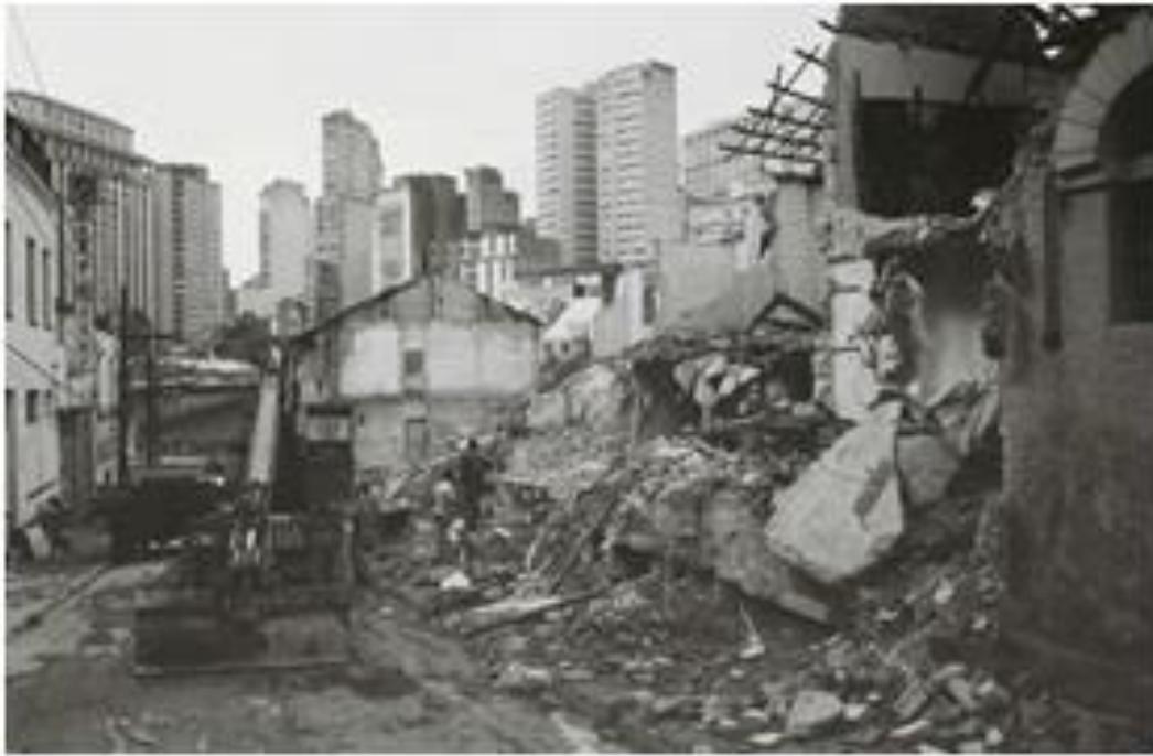
Figura 6 - A demolição das edificações na rua da Jandaia em 1987. Fonte: Fotografia de Israel dos Santos Marques. Disponível em www.acervosdacidade.prefeitura.gov.sp.br . Acesso em 22 jul. 2019.
