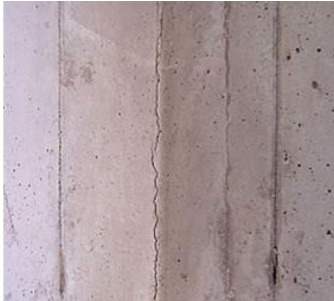
Figura 23 - Exemplo de fissura em parede de concreto.
