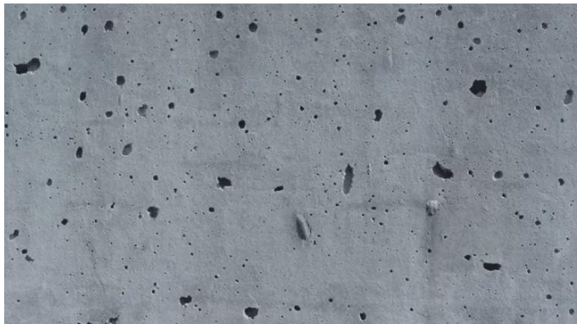
Figura 22 - Bolhas de ar incorporado nas paredes de concreto.
