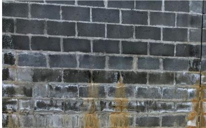
Figura 5 - Eflorescência na Alvenaria Estrutural
