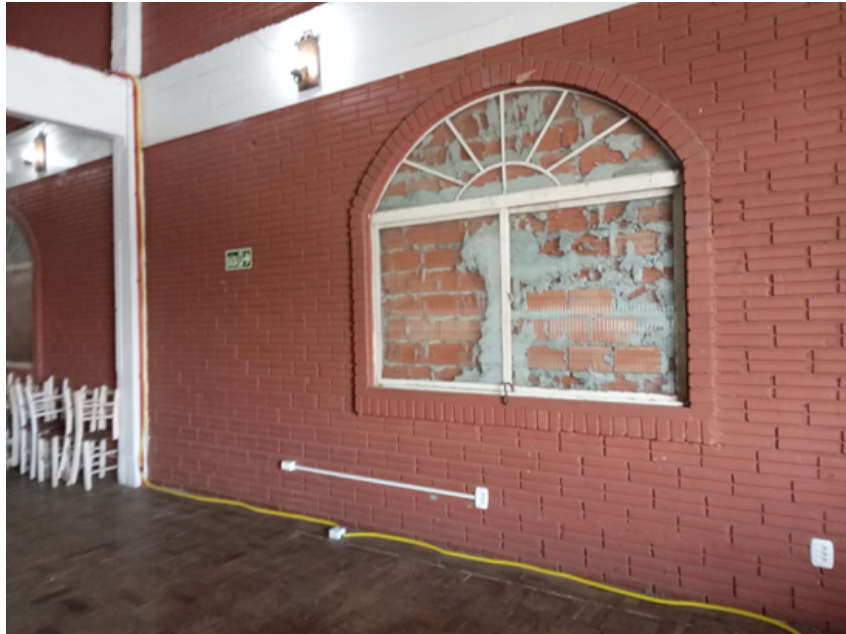
Figura 15 – Esquadria coberta com alvenaria devido problemas com a acústica.
