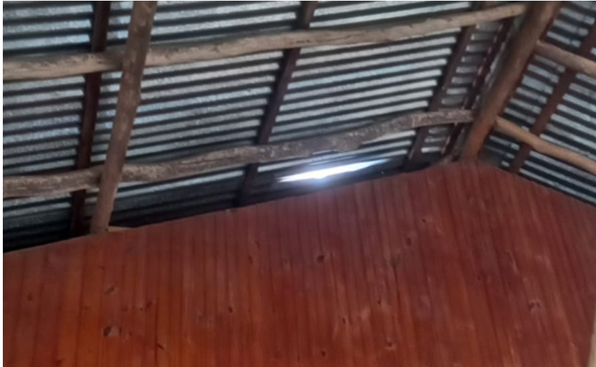
Figura 13 – Fresta no fechamento entre cobertura e paredes em entidade tradicionalista.
