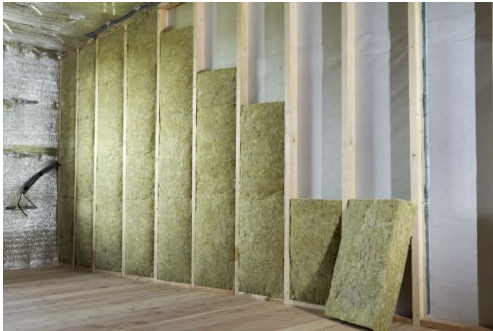
Figura 21 – Exemplo do uso de lã de rocha para isolamento acústico.
