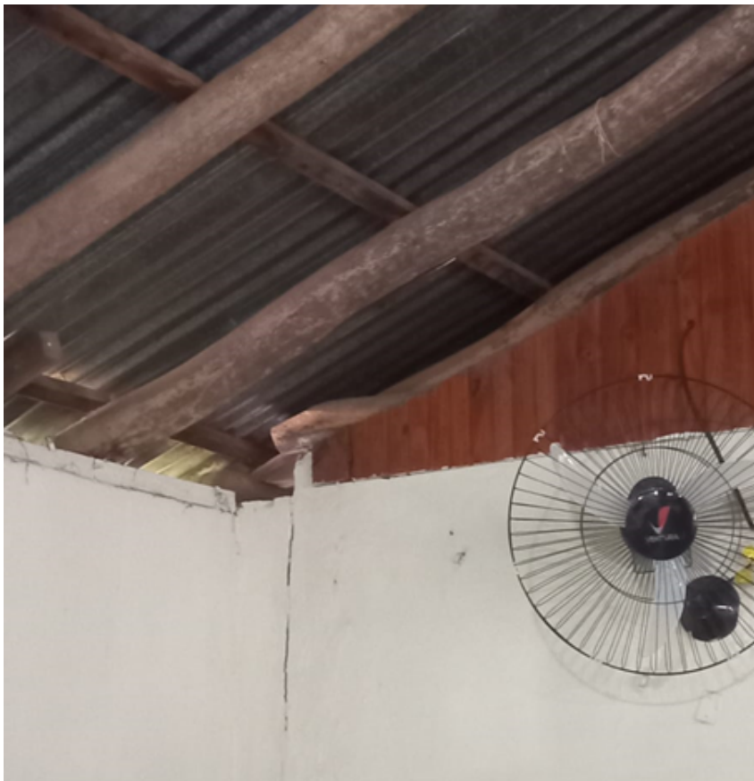
Figura 14 – Fresta no fechamento entre cobertura e paredes em entidade tradicionalista.
