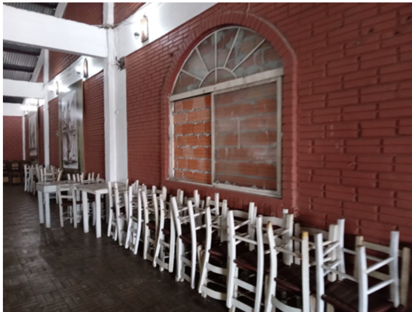
Figura 16 – Esquadria coberta com alvenaria devido problemas com a acústica.
