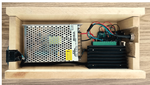
(a) Interior do sistema de controle.
